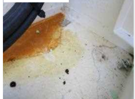
浸水した痕跡
